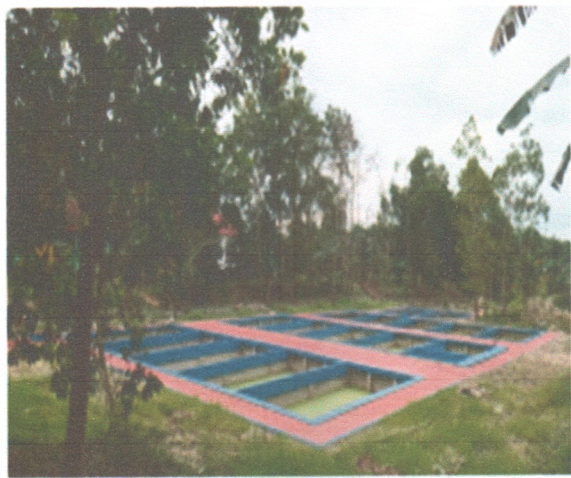
Instalasi Pengolahan Lindi TPA
